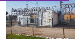
Generación electricidad c/H2
